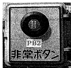
非常押しボタン
