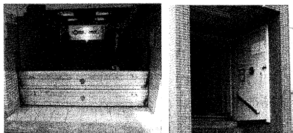
止水板・防水扉の整備
