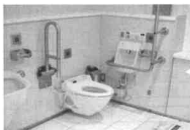
障害者対応型トイレ
