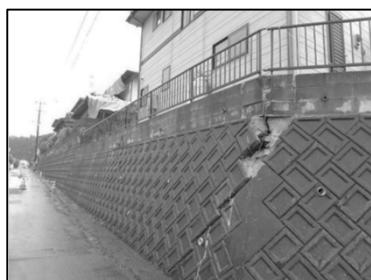
宅地被害(擁壁の亀裂)
