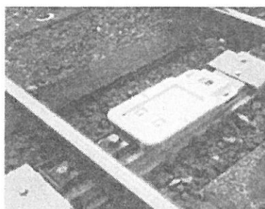
自動列車停止装置 (ATS) の整備
