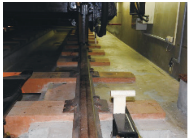
写真6：打子式ATS（自動列車停止装置）
