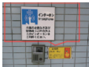
非常用インターホン（ホーム）
