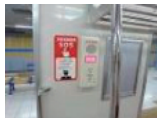
非常通報装置（車内）
