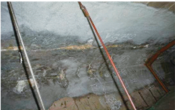
天井部の遊離石灰
