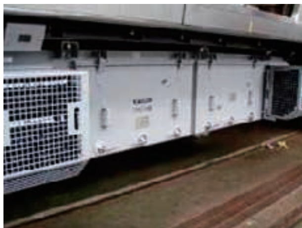
写真－7 制御装置
