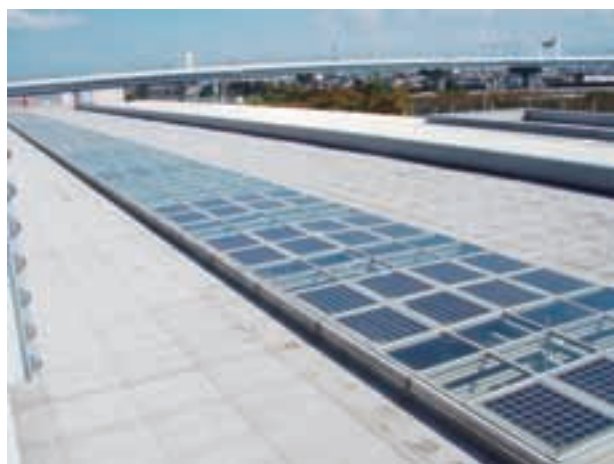
図4 太陽光発電パネル
