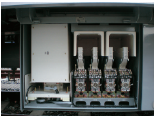
写真7 高速度遮断器および断流器
