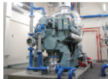
非常用発電機
