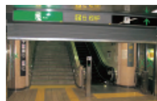
防火防煙シャッター
