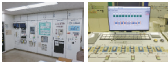
駅の防災盤・排煙操作卓（運転指令）
