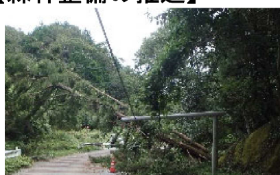
倒木により電線断線
