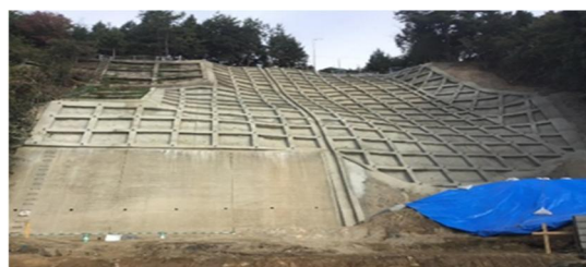
コンクリート枠による斜面の補強
