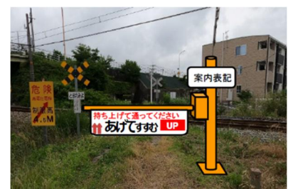
第４種踏切の安全対策を簡易かつ 効果的に実施できる設備の例
