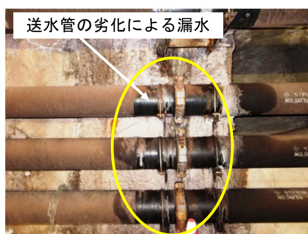
消火施設への送水管の劣化
