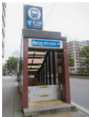
駅出入口の止水板
