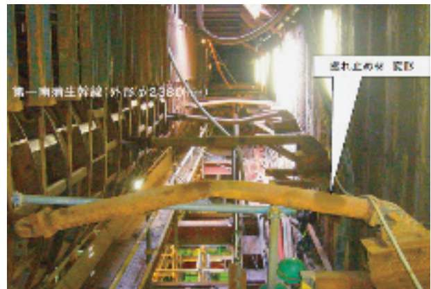
写真-5 地下埋設物部材の変形
