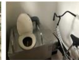
バイオトイレの 整備
