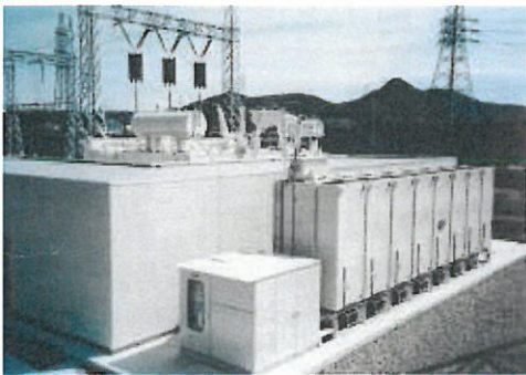
犬山開閉所 STATCOM 全景
