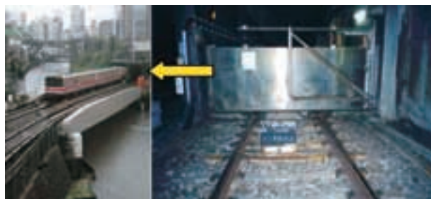
図-5 坑口防水ゲート
