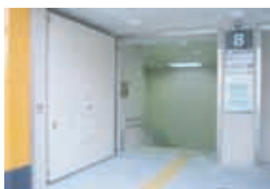
止水扉(出入口地上)
