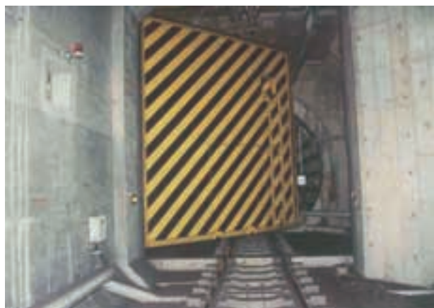
図-4 トンネル内防水ゲート
