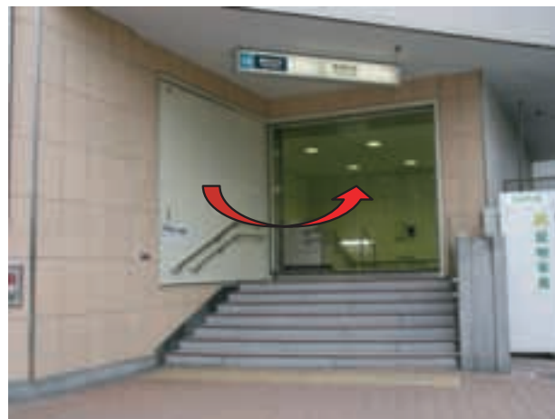
図-2 駅出入口の嵩上げと防水扉
