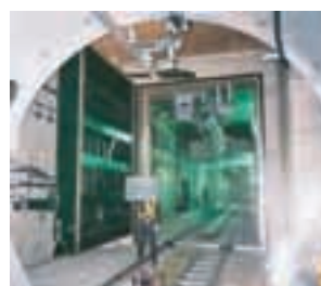
防水扉(線路部)
