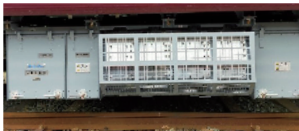
補助電源装置
