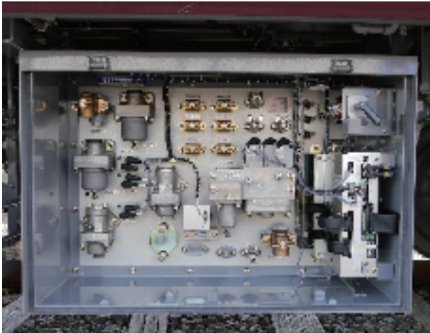
ブレーキ制御装置
