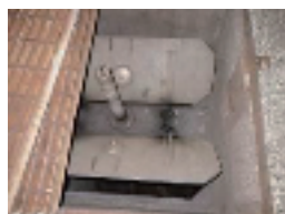
浸水防止機（通風口）
