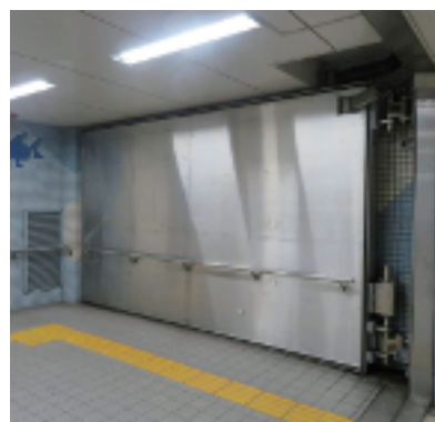
防潮扉（電動式）
