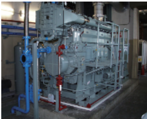
非常用発電機
