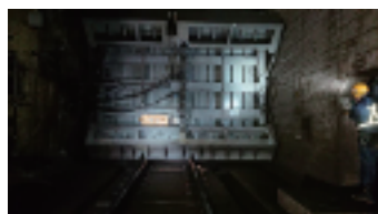
トンネル内防水ゲート
