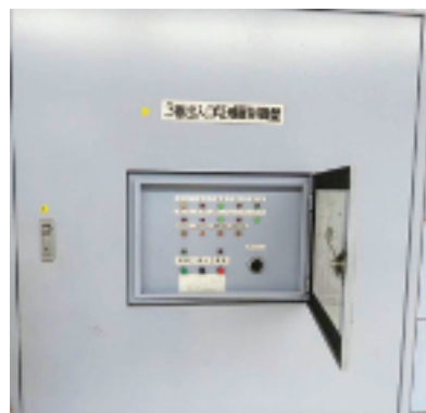
防潮扉（電動式操作盤）
