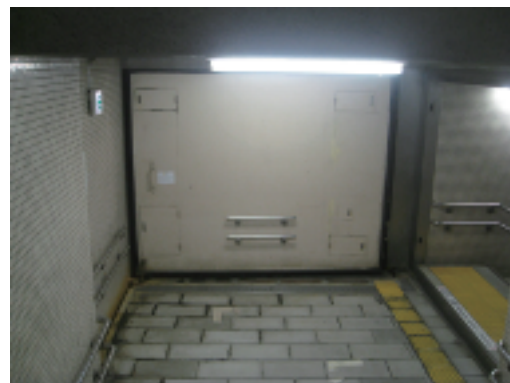
防潮扉（手動式）
