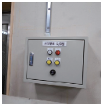
警報装置 駅長室前制御盤
